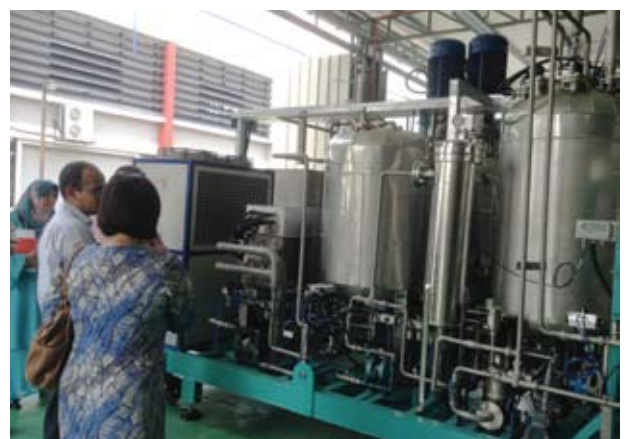
Unit pemprosesan biodiesel di UNITEN
