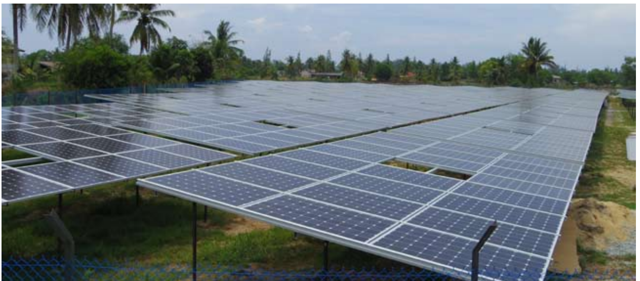
Ladang solar di Tok Bali, Kelantan
